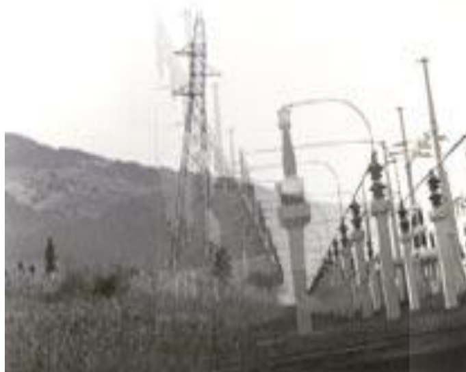
- Poste électrique THT 400/220 KV d'El – Affroun –
