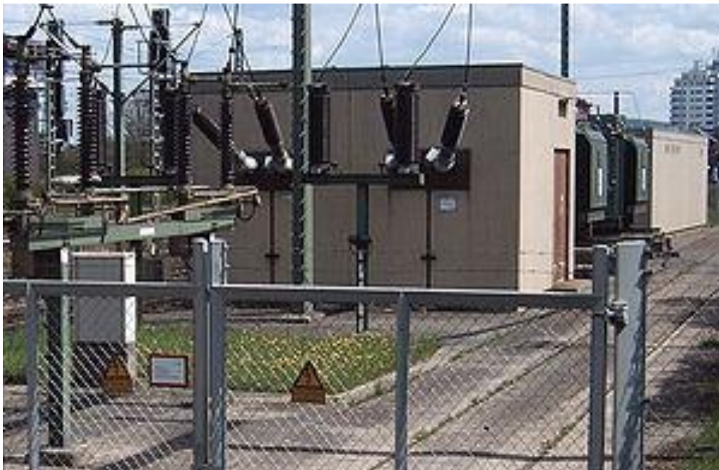
- Poste électrique H.T 60/30 KV -
